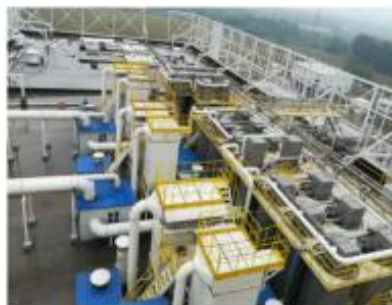
第二代废气处理设施： 三级过滤+沸石转轮吸附+RTO焚烧
