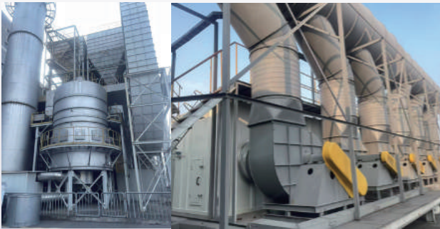
RTO治理设施
